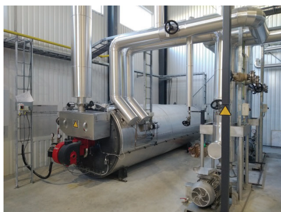
2.att. Gāzes katls
